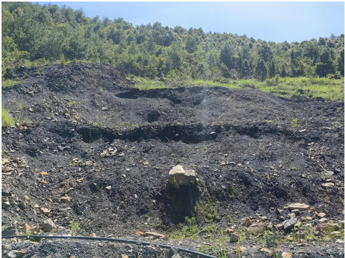
照片11：巫溪县峰灵镇庙溪村煤矿煤矸石堆积边坡
