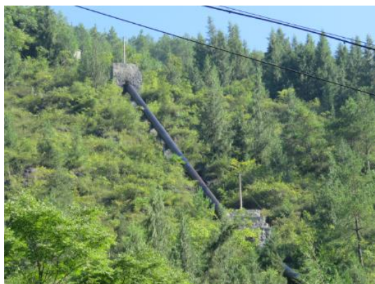
图2.1-5 石龙电站压力管道
